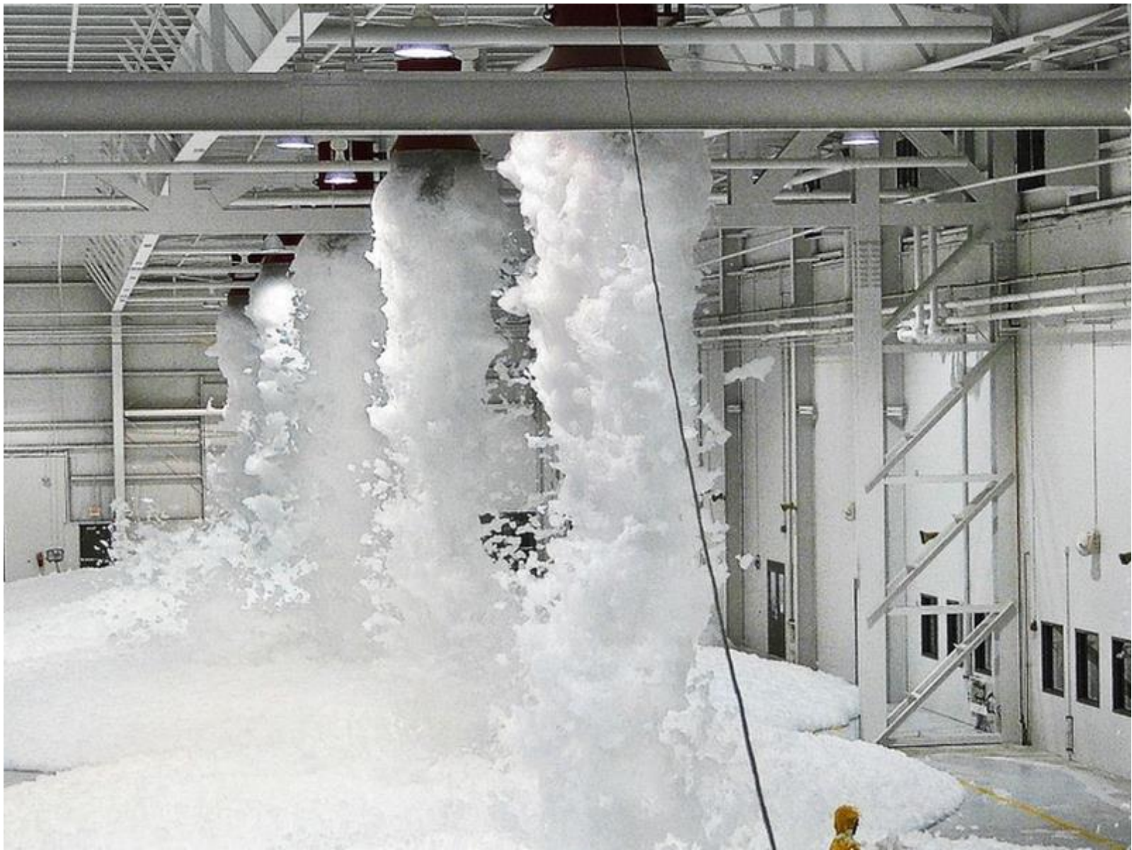
Дренчерная система тушения пожара пенным составом
